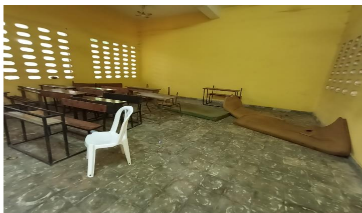
Figure 8 : présentation d'une salle de classe avec des équipements insuffisants et abîmés
